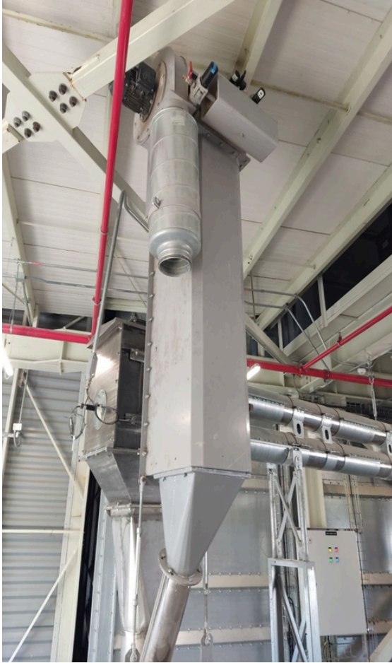
Figura 10: Filtro spot Poeth completo (portafiltros y ventilador).
