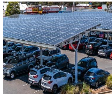
Figura 12: Paneles solares como techo de estacionamiento. Fuente.
