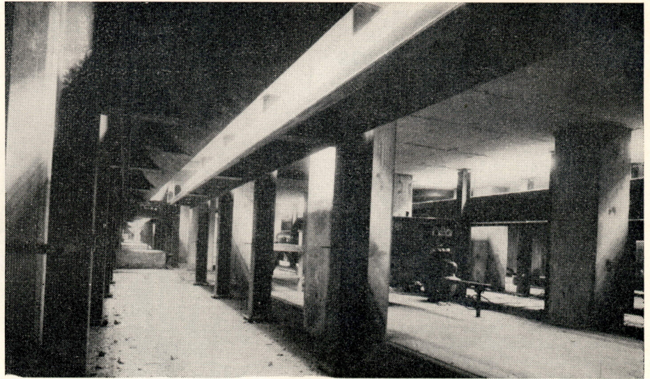
Buzones: En el nuevo Concentrador de Colón del Mineral El Teniente, los buzones de descarga de mineral fino ya están terminados.
